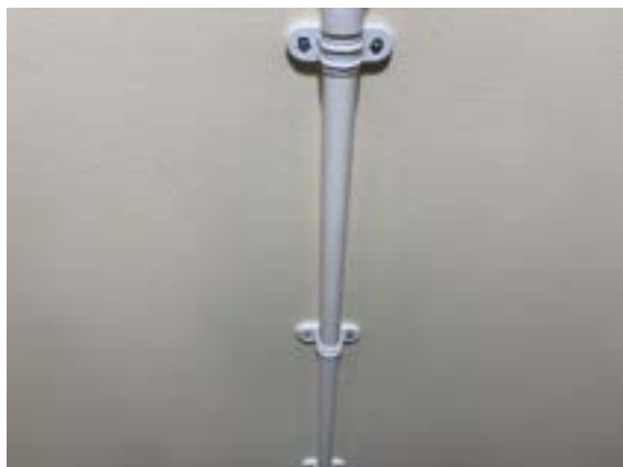
Steel Conduit Brackets
