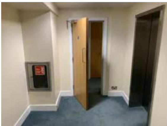
Fire Door - Not Shutting
