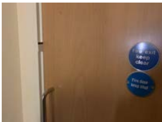
Fire Door Signage
