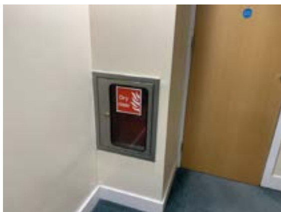
Dry Riser Outlet
